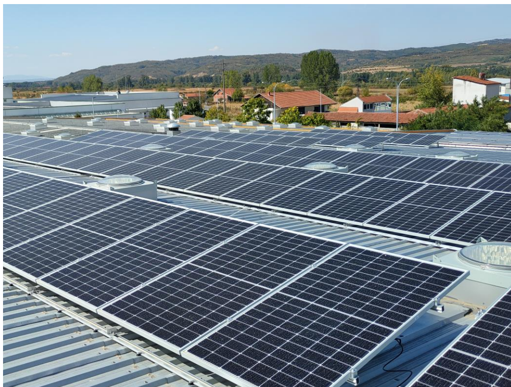
Slika 5. Solarna elektrana na krovu fabrike Gruner Serbian u Vlasotincu
